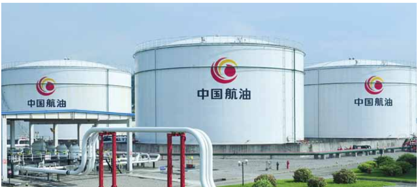
CNAF storage facilities in China CNAF 在中国的储罐
